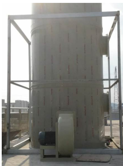
图 3.3-18 污水站废气处理设施
